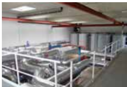
Verrohrung großes Kesselhaus
